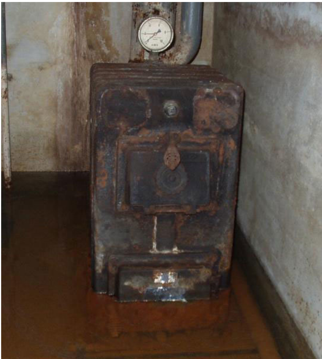
Отопительный котел (из архива автора)
