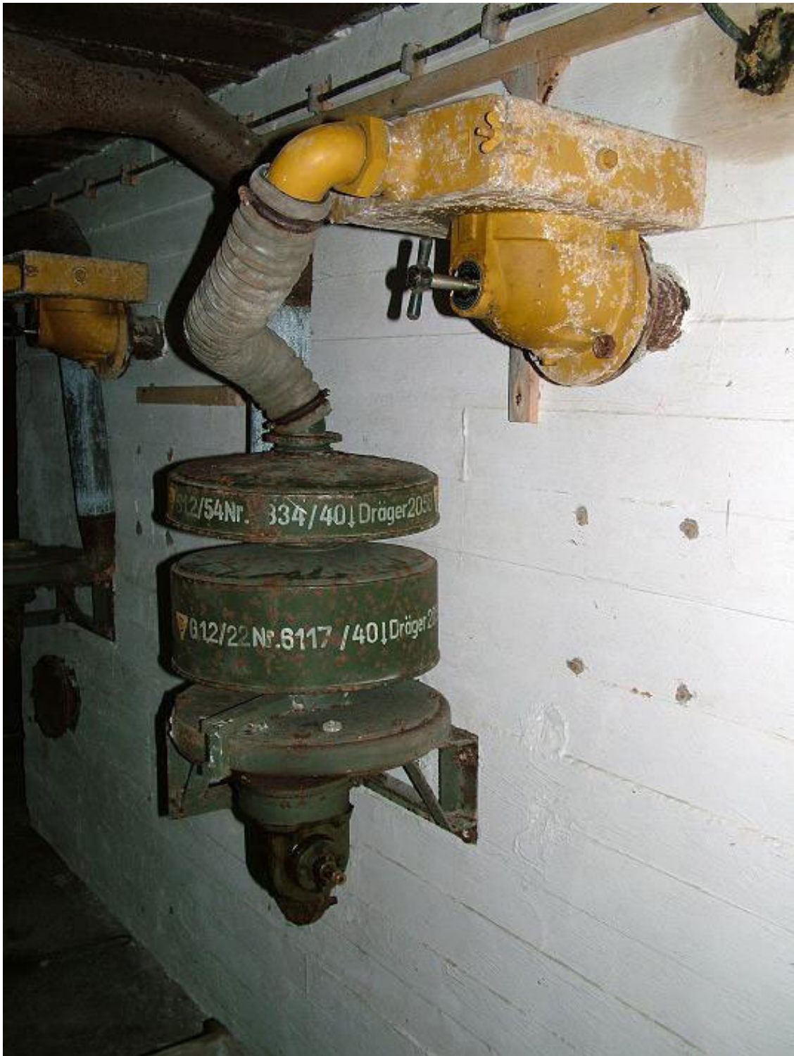
Фильтро-вентиляционная установка (из архива автора)
