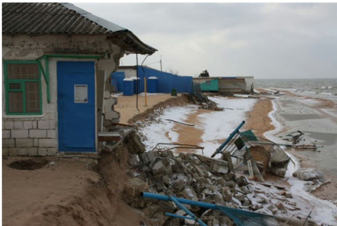
Рис. 1.3. Разрушение береговой линии и хозяйственной постройки на Таманском полуострове в результате нагона воды ( http://www.ucn.su/?p=8954 )
