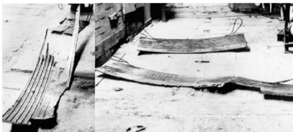
Рис. 14. Аварийное разрушение неподвижного кольца нижнего лабиринтного уплотнения рабочего колеса гидротурбины СШГЭС
