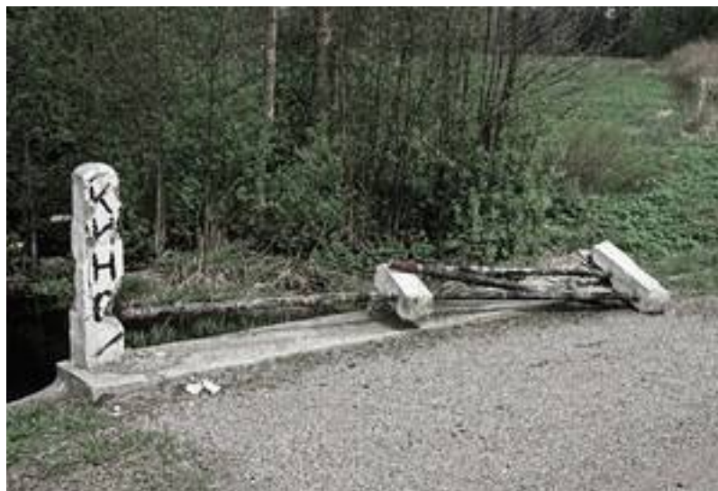
Повреждённые ограждающие столбики через речку Тейтуне
