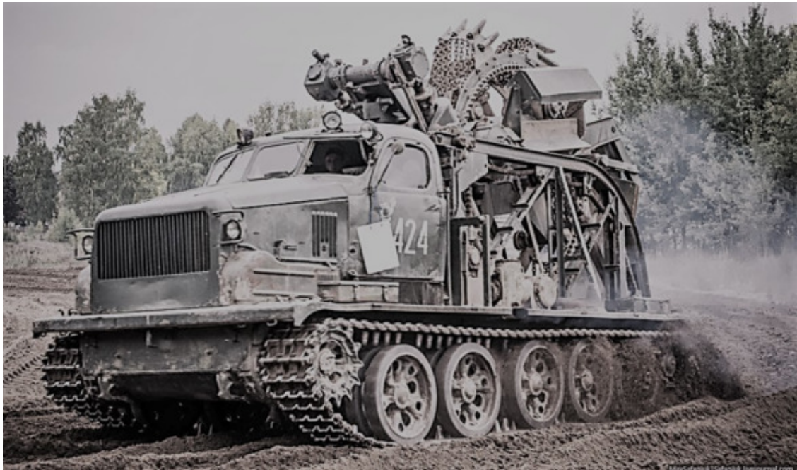
БТМ-3. Армейская машина для быстрой прокладки канав и траншей в различных грунтах от песчаного до мерзлого.
